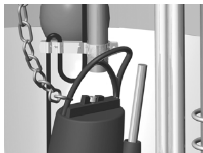
Fig. 15 Kätting fäst på pumpen
